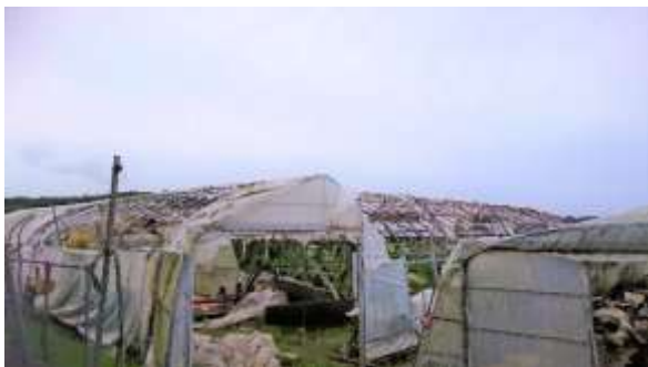
〈強風と濁流で壊滅した杉内農園のハウス群〉
