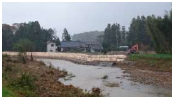
〈決壊し越流した太田川堤防(杉内邸西隣)〉
