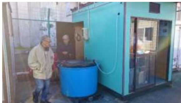
〈南相馬市鹿島区NPO「あさがお」ミニプラント (500L メタンガス貯留タンク)〉
